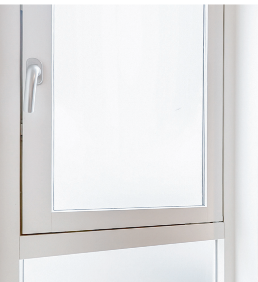
Annette Rask kunne blandt andet fastslå, at vinduerne var monteret forkert.
