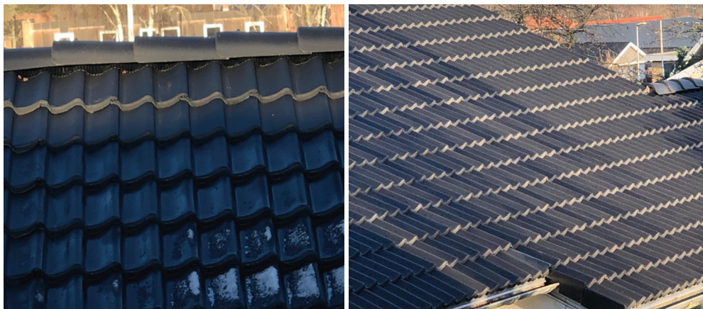
Det var indsvivende vand fra en utæthed i tagkonstruktionen, der udgjorde problemet. Det påviste Rask Boligrådgivning ved at simulere et uvejr.
